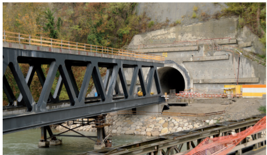
Nach langen Verzögerungen wird in Genf mit der CEVA der ÖPNV nach Frankreich ausgebaut. Hier führt die Brücke über die Arve direkt in einen Tunnel unter dicht überbautem Gebiet nach Annemasse.
